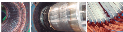
Figura 5. Daños típicos en núcleos laminados.
