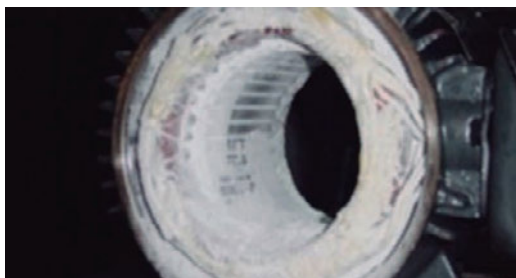
Figura 6. Exceso de contaminación interna.
