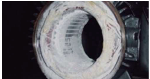
Figura 6. Exceso de contaminación interna
